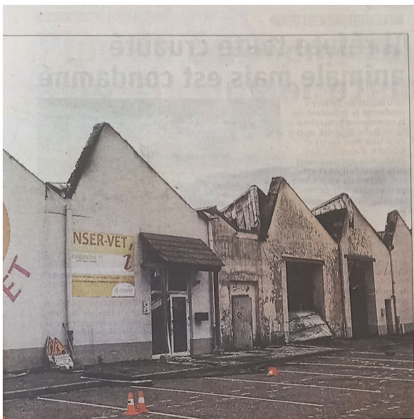
2 200 m 2 de locaux appartenant à l'association sont partis en fumée lors de l'incendie de Valdoie en juin dernier. Photo d'archives ER/Michaël DESPREZ
